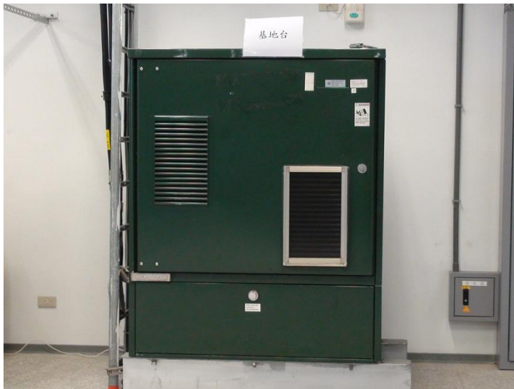
R70802 基地台 Base station
